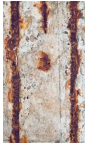
Durchrostungsschäden und Abplatzungen an einer Betondecke ohne ISO-PLUS-SYSTEM® nach nur 12 Jahren Badebetrieb - trotz vorhandener Außendämmung.
